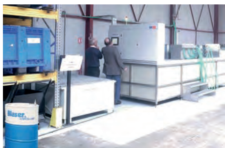
» Installation 4.0 avec gestion centralisée du lubrifiant
